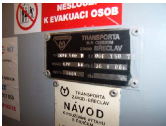
výrobní štítek v kabině výtahu
