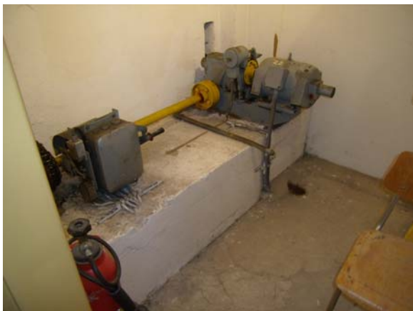
Strojovna výtahu – stroj S2 NGS 500 + KVZ
