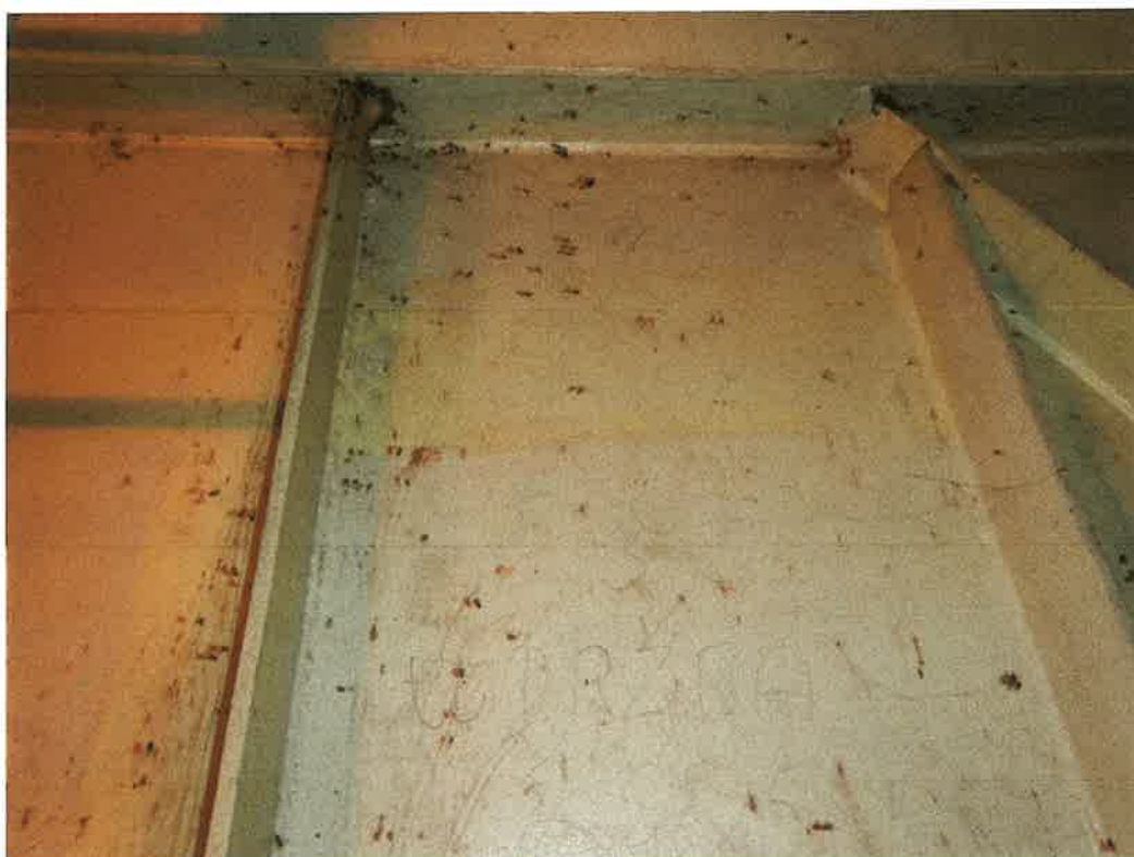
Obr. 36 Znečištěná vnitřní stěna pylonu hmyzem
