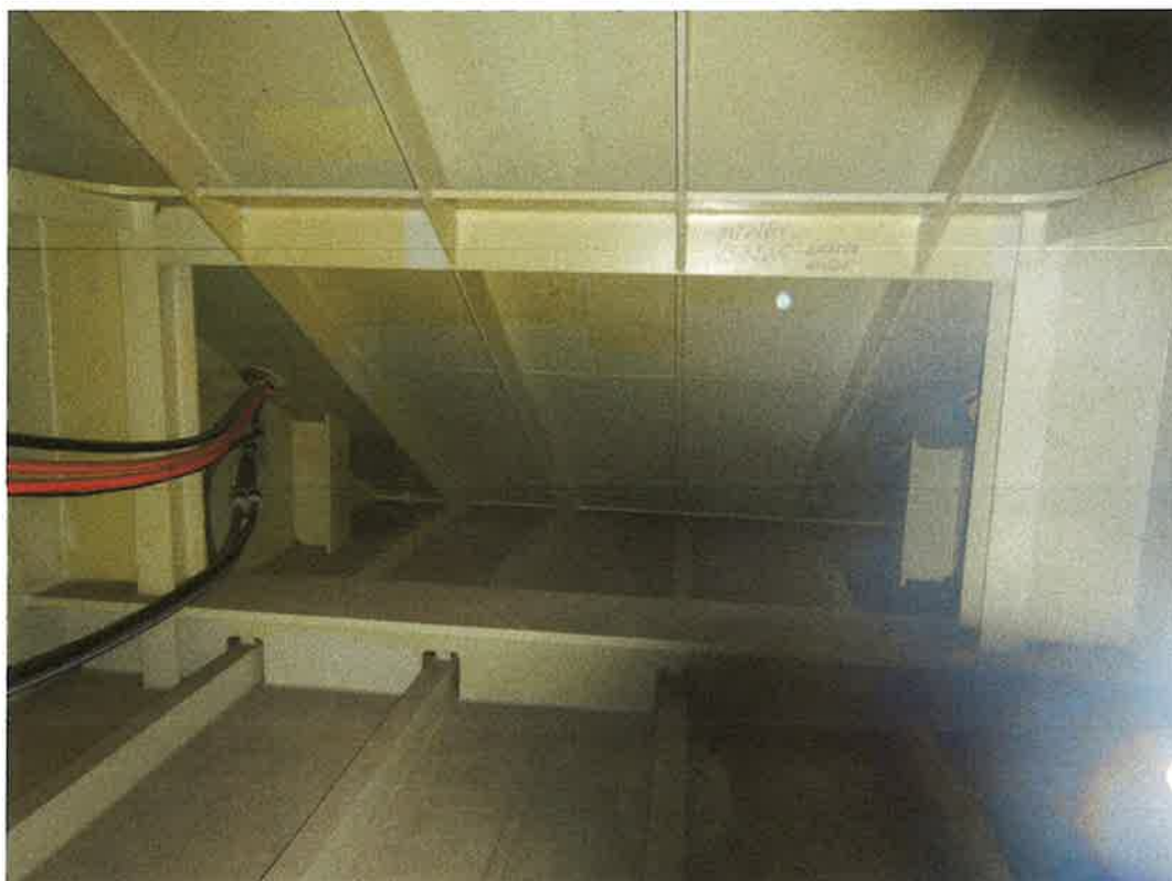
Obr. 28 Konec dutiny hlavního trámu, čistý bez plísně
