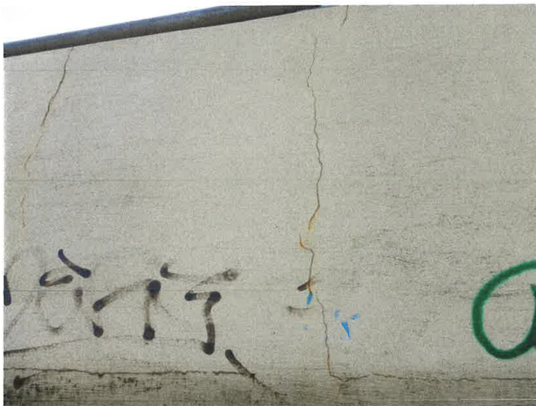
Obr.45 Detail trhlin na zídkách výstupu z podchodu na chodník mostu
