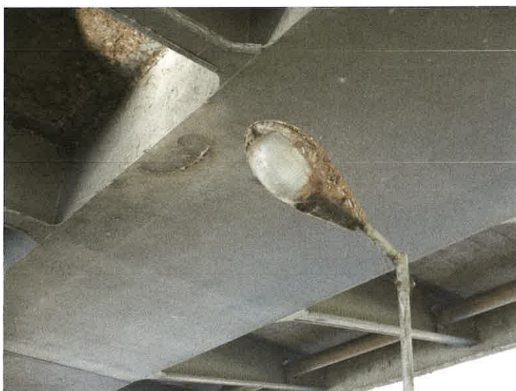
Obr.64 Mostní rampy, znečištění osvětlovacích těles pod rampami
