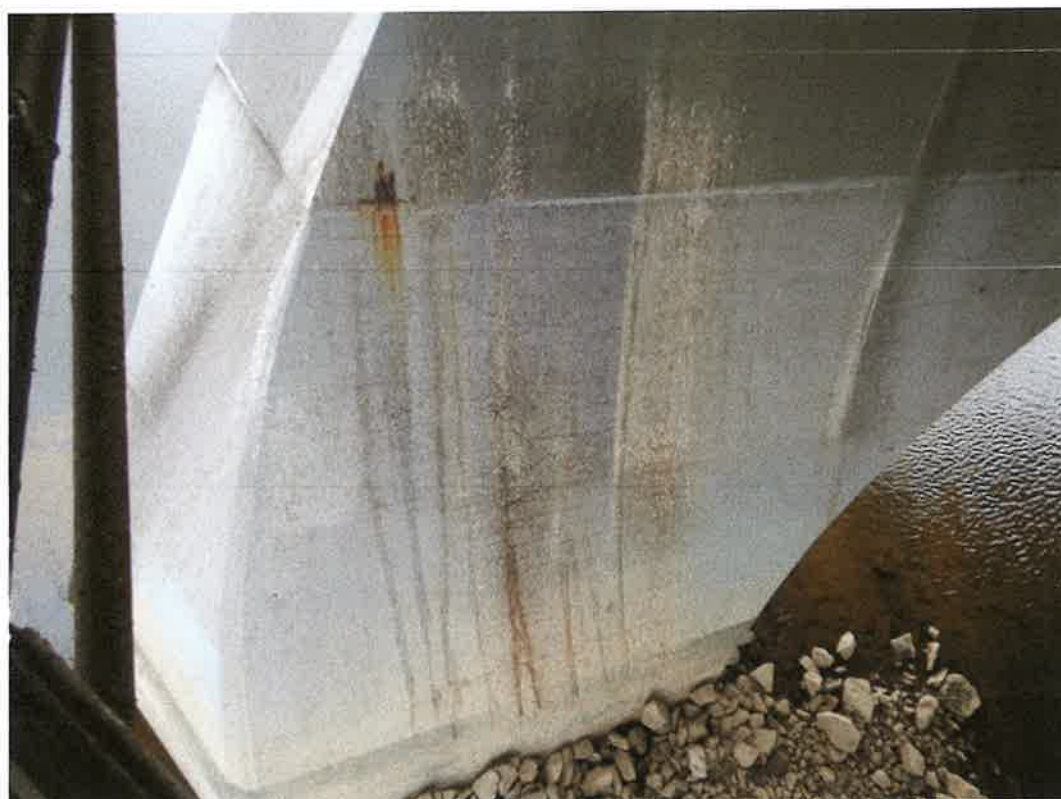
Obr. 12 Znečištěný povrch vnitřního líce pylonu pod mostovkou od ptačího trusu
