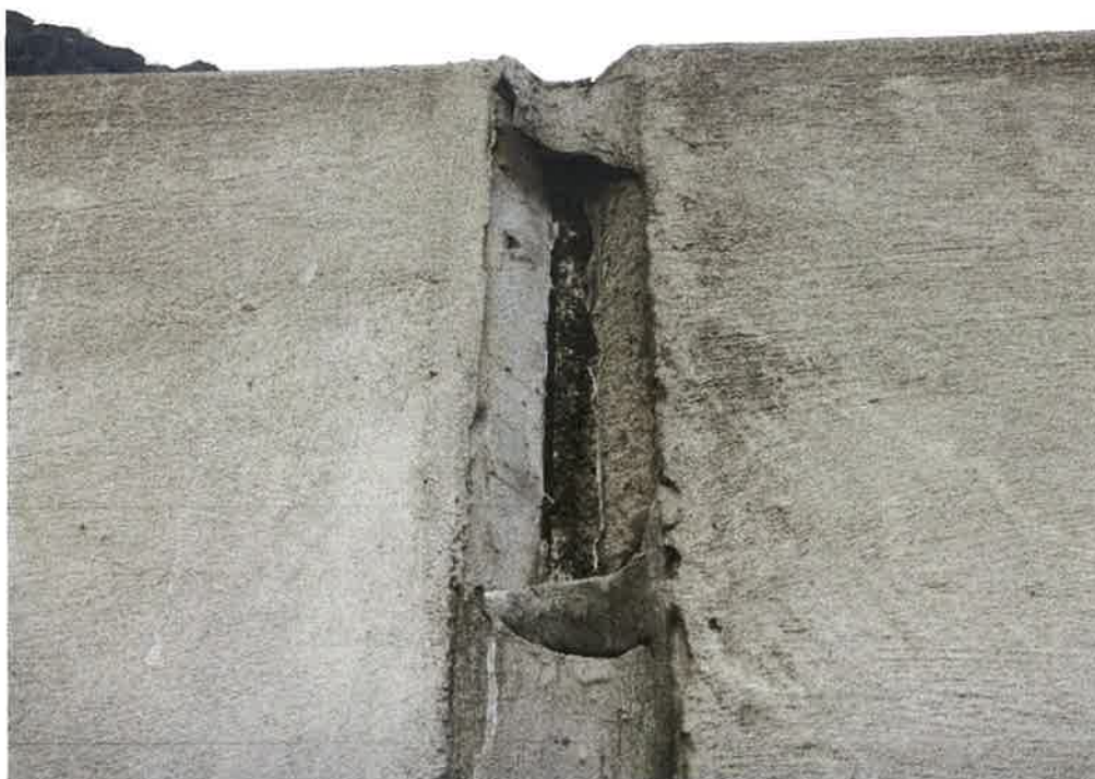
Obr. 65 Degradace dilatačních spár opěrných zdí navazujících na rampy
