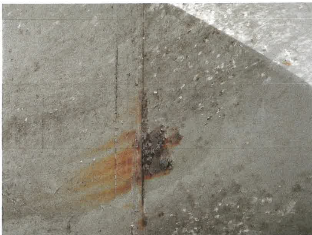
Obr.14 Detail koroze na pylonu po odkapávající vodě z trubičky izolace
