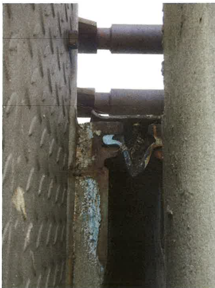
Obr. 46 Zanesený mostní závěr u opěry Střekov
