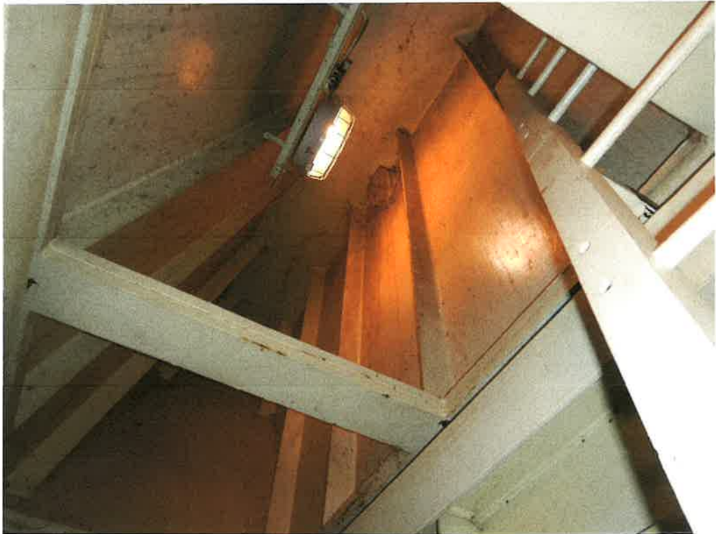
Obr. 37 Vrcholová část hlavy pylonu znečištěná od hmyzu
