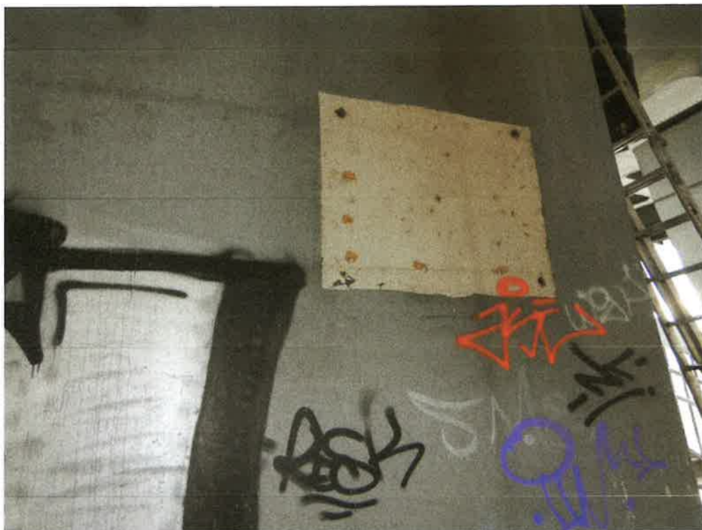
Obr. 55 Opěra č. 1, světlé místo po chybějící tabuli s označením mostu
