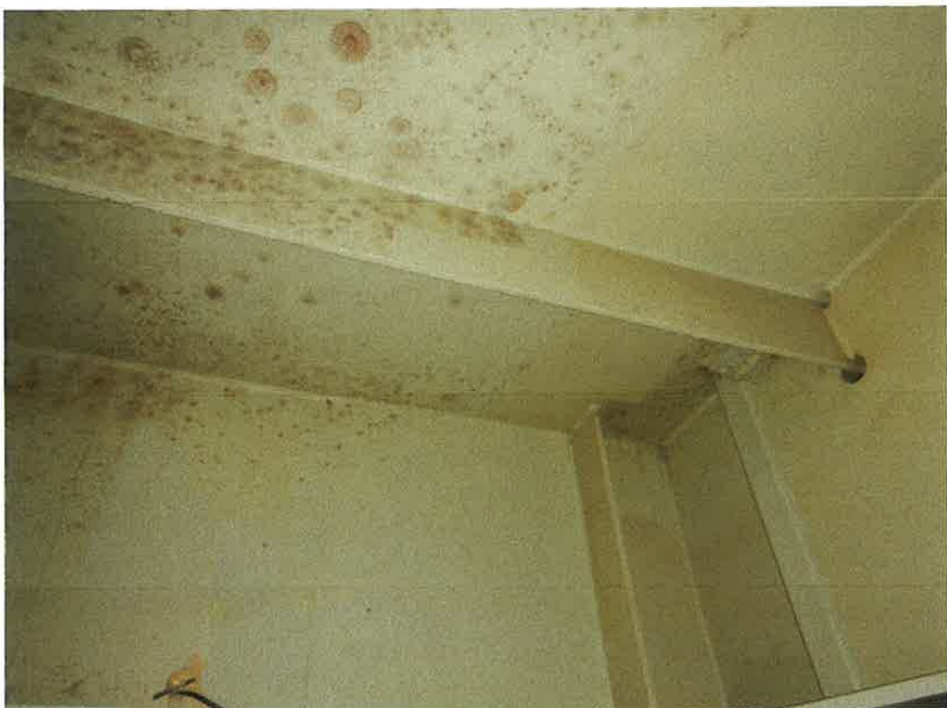
Obr. 26 Plíseň na stěnách i stropu některých částí tubusu
