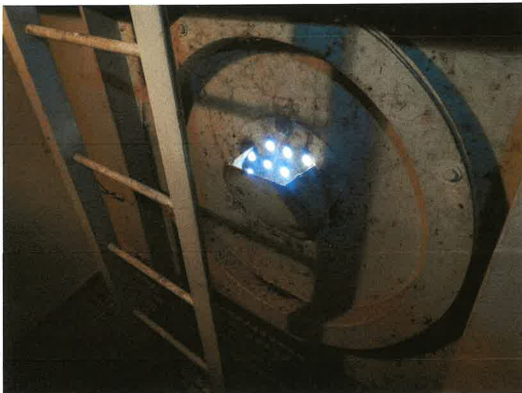
Obr. 35 Znečištěné kruhové vstupy na křídla 2 až 4 od hmyzu
