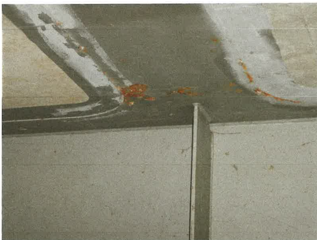
Obr. 10 Krajní pole povrchová koroze oblastí kolem spodních pásnic příčníků
