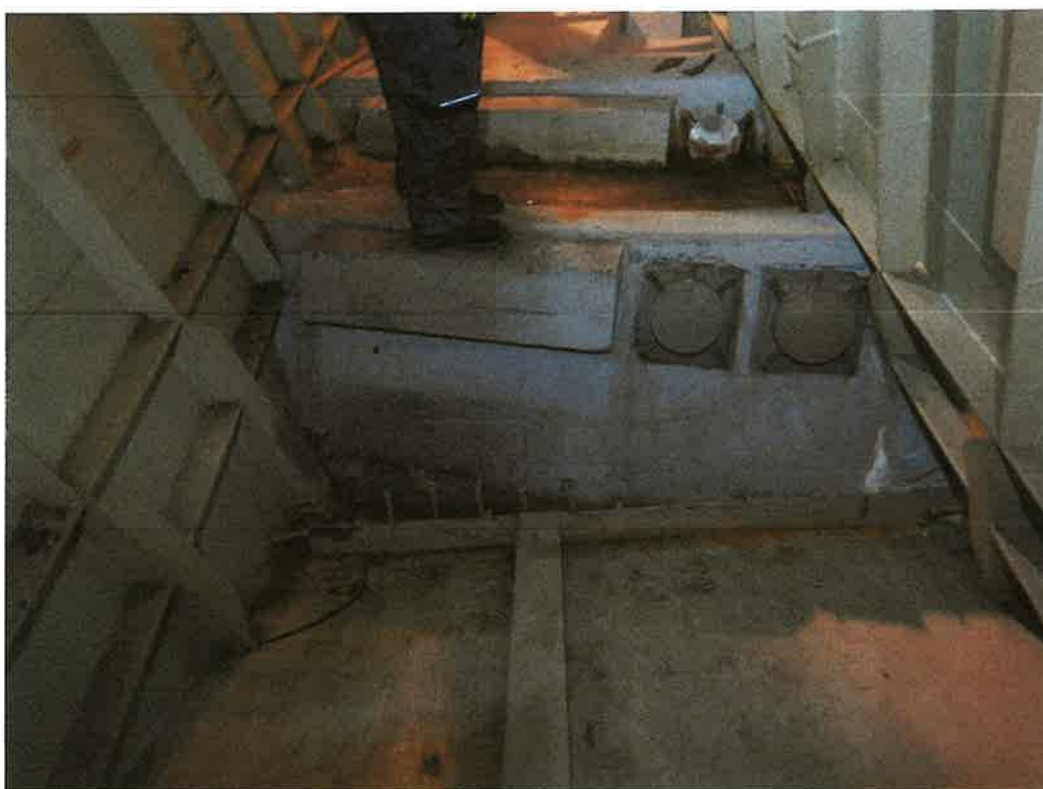
Obr. 22 Spára ocel/beton s kotvami se zatékající vodou (viz obr 20), pohled
