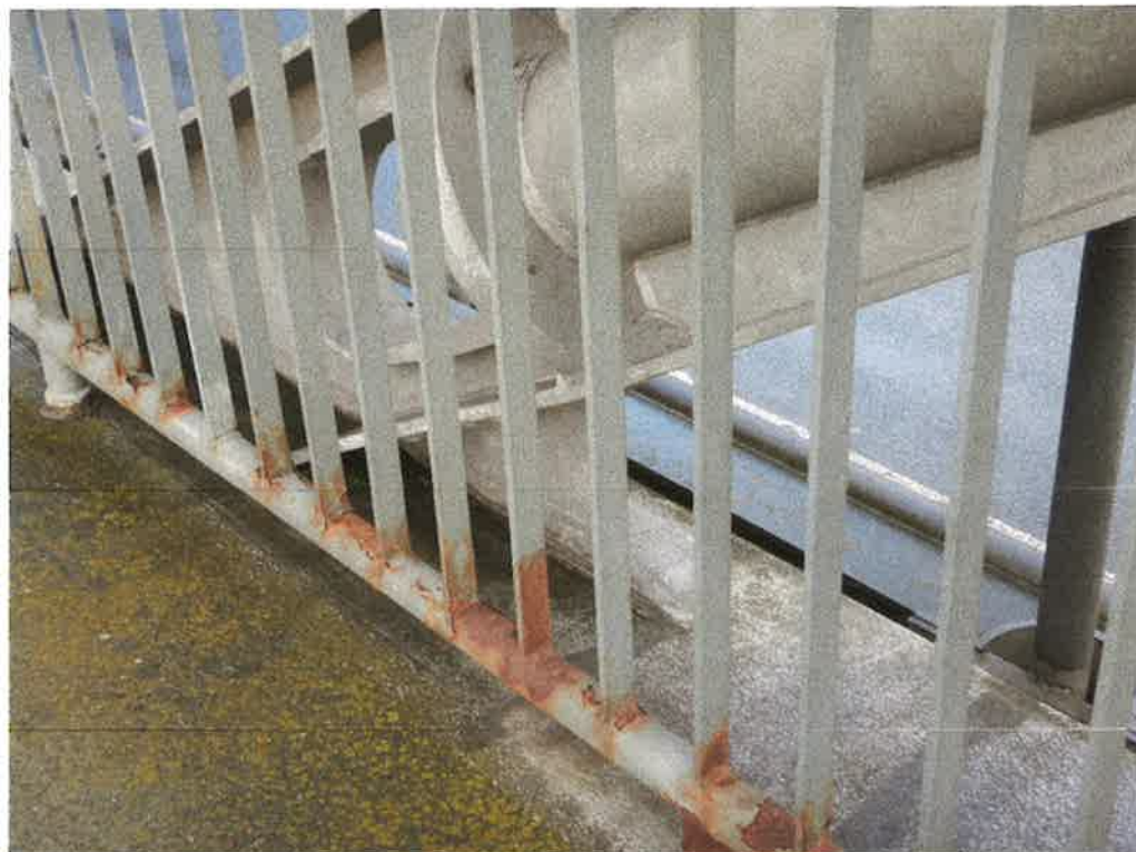
Obr. 49 Detail koroze zábradlí, řešeno v jiném režimu oprav
