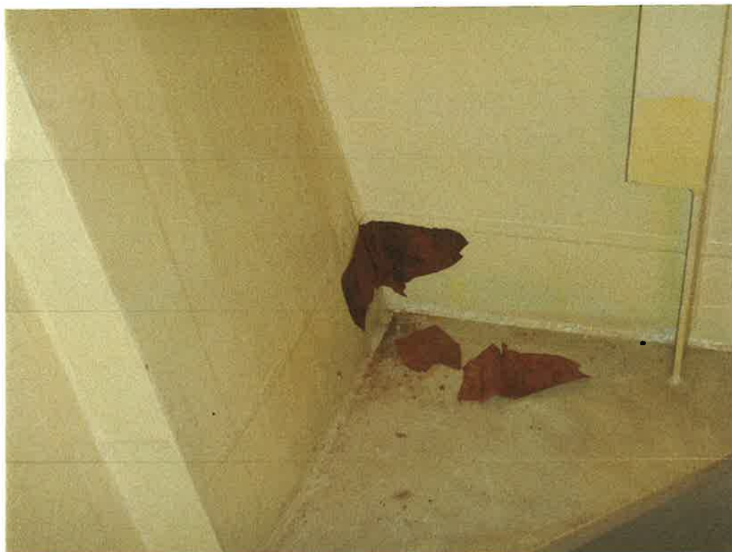
Obr. 29 Odloupnutý nátěr a rez na několika místech, HPM neřeší PKO
