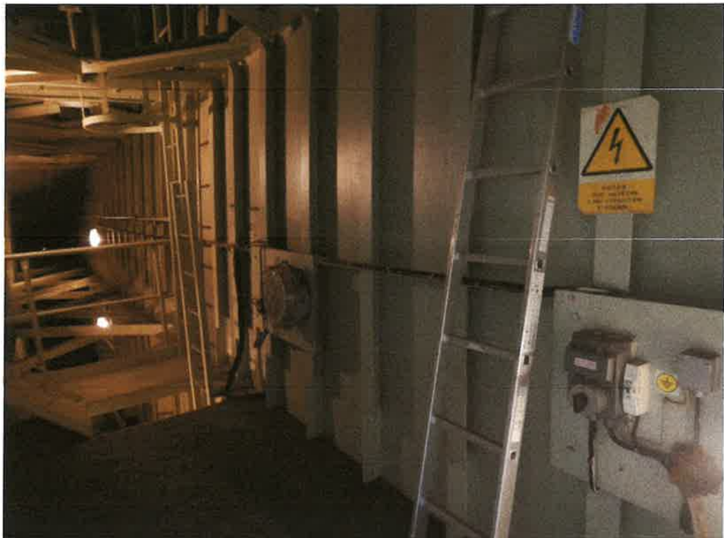
Obr. 38 Rozvodná deska osvětlení vnitřních prostor pylonu při vstupu do mostu
