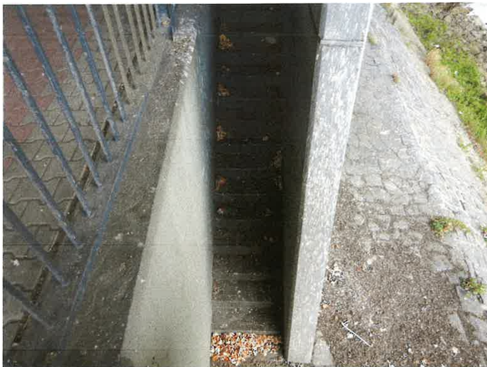
Obr. 57 Znečištěný prostor schodiště dolů k řece u opěry č. 1
