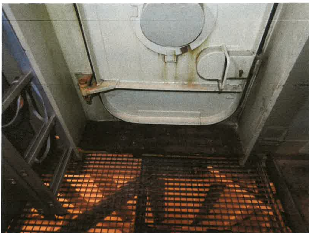
Obr. 20 Vstupní dveře z revizního vozíku dovnitř pylonu, netěsní, koroze kotev
