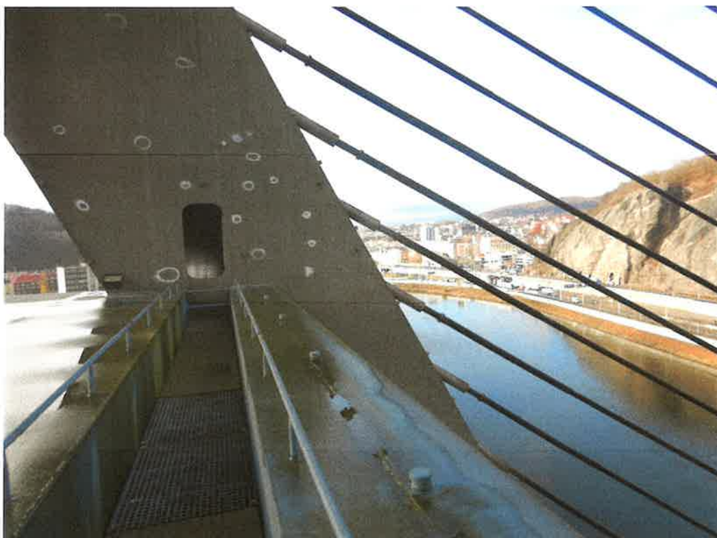
Obr. 32 Vstup na první křídlo s pochůzí lávkou. Vady v PKO HPM nesleduje
