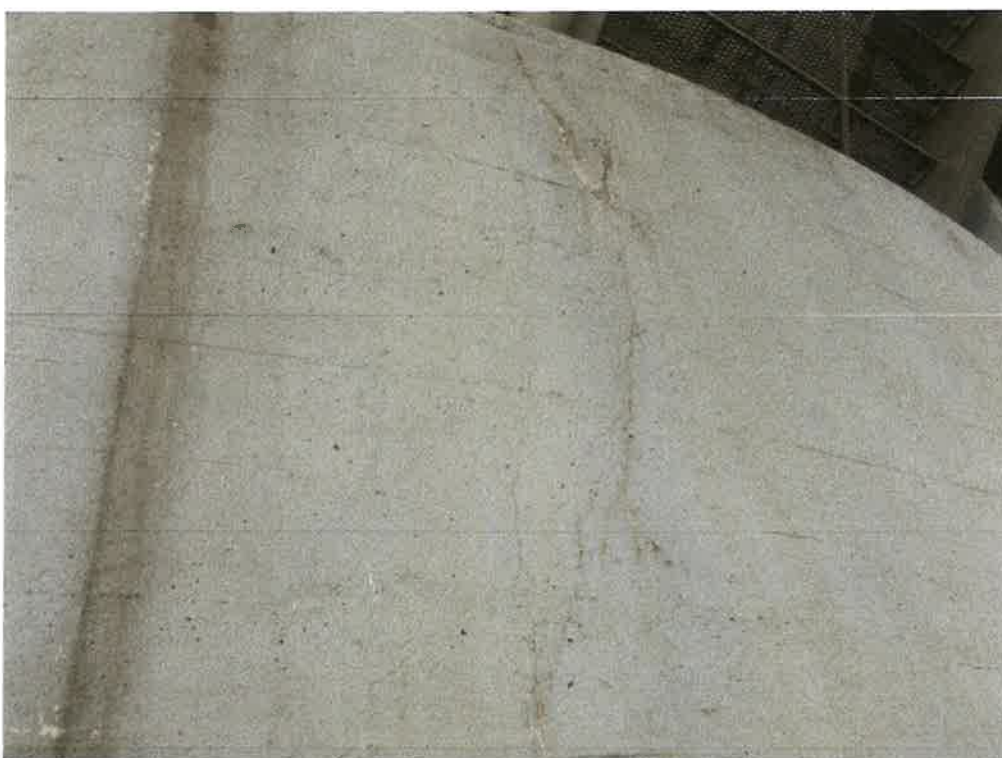
Obr.58 Systém svislých smršťovacích trhlin na opěře č.1
