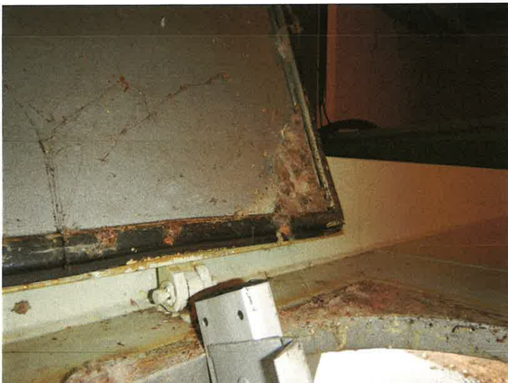
Obr. 19 Otevřený poklop vstupu do tubusu trámu, znečištěný
