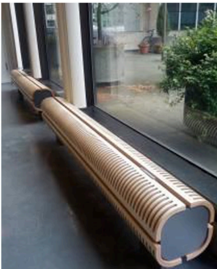
radiatory JAGA KNOCKONWOOD vstupní hala a přepážková pracoviště
