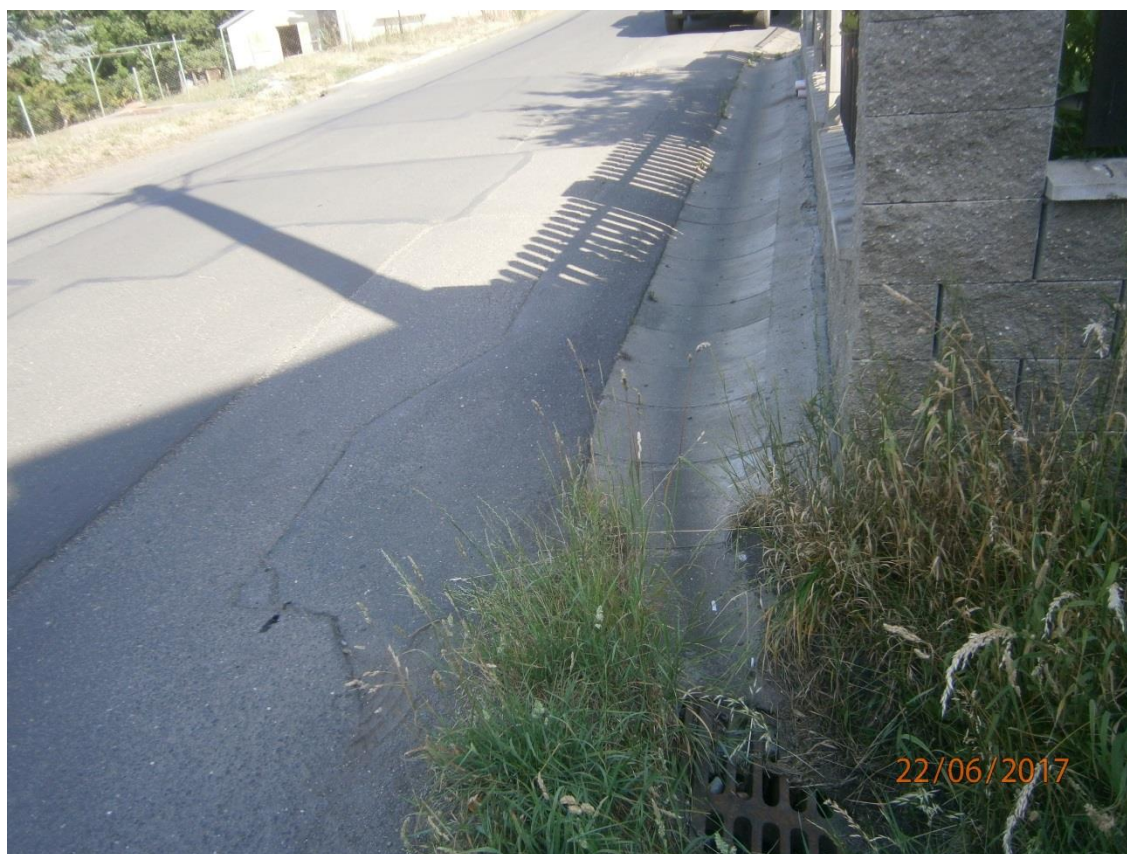
Fotografie č.2 Uliční vpust' na levé straně komunikace
