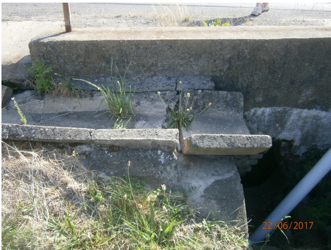
Fotografie č.7 Žlab podél pravé strany komunikace – vyústění nad stávajícím odtokem dešťových vod
