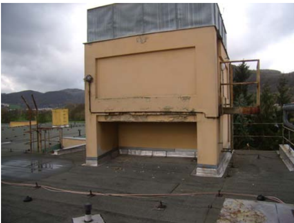
Strojovna s montážním výklenkem
