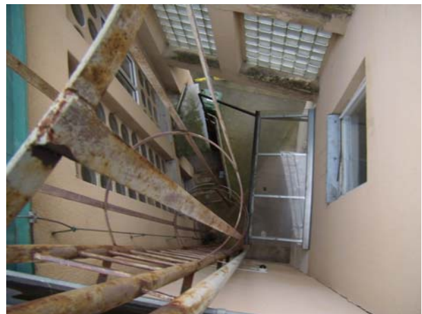
otevřený světlík s požárním žebříkem na střechu
