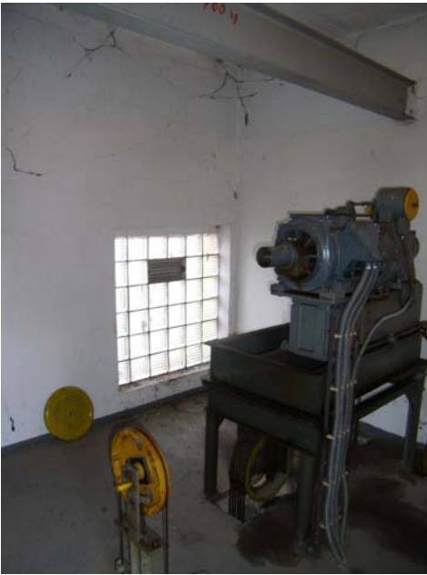
Výtahový stroj SB 411 na roštu s kladkou
